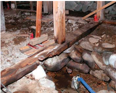
解体中のシュウズ場：シュウズをまたいでいる土台がシュウズからの湿気で腐っている。
