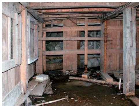
修理前倉庫：正面側土台が腐朽して無い状況。
